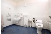
多目的トイレ ※金トイレ簡所(5カ所)に設置 ●大人用ベッド設置(B1/1カ所、2F/2カ所) ●オストメイト対応(B1/1カ所、1F/1カ所、2F/1カ所)
